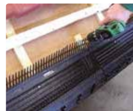
8 Ondersteuning voor de koppeling van twee Vogelvide elementen kan door een extra stukje tengel, van dezelfde dikte, aan te brengen.
