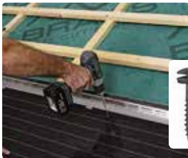
25 Schroef de modules met de bijgeleverde schroeven van RVS door de aanwezige stansgaten vast op de panlatten.
