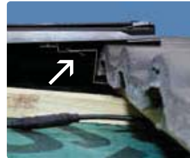
49 De profielrail aan de dakvoet en de rail van de module moeten in elkaar grijpen.
