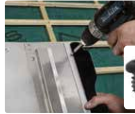
45 Schroef het dakvoetaansluitprofiel met de bijgeleverde schroeven vast in de aanwezige voorziening.
